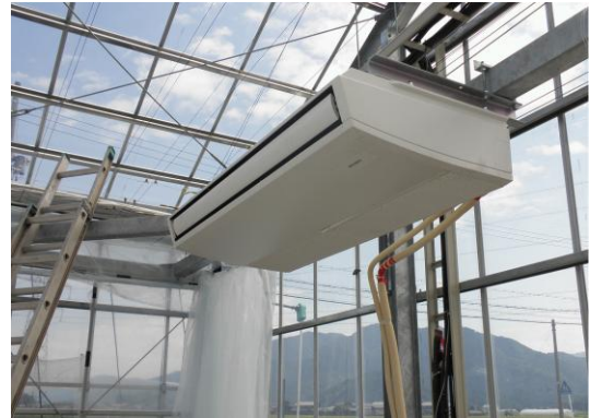
ヒートポンプ（室内機）
