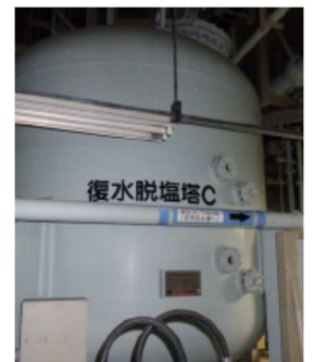
復水脱塩装置
