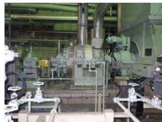
主給水ポンプ
