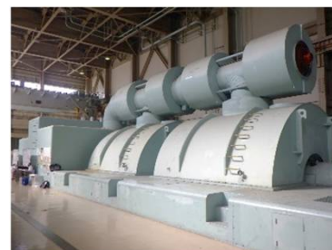
蒸気タービン
