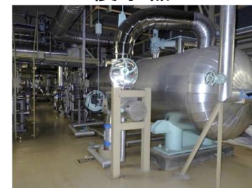
高圧第1給水加熱器
