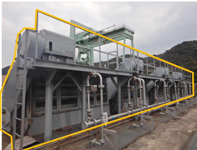
海水除塵装置
