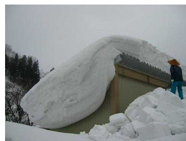
記録的豪雪に埋もれた貯雪室 (2006年1月)
