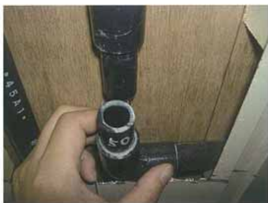
貯雪室冷却配管(垂直部)
